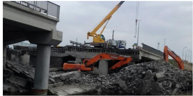
Рис. 2. Зруйновані плити ПБ 3-4 та ПБ 4-5
